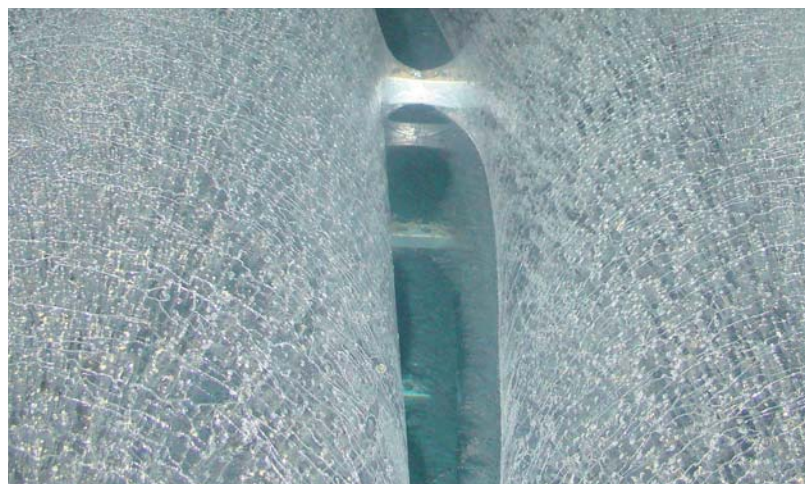
Eisbildung um den Wärmeüberträger im Eisspeicher
